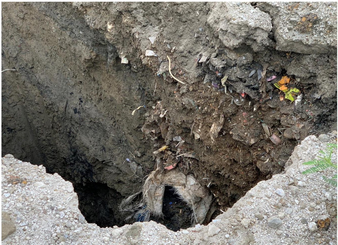
照片說明：現場土壤開挖發現下層掩埋混合事業廢棄物
